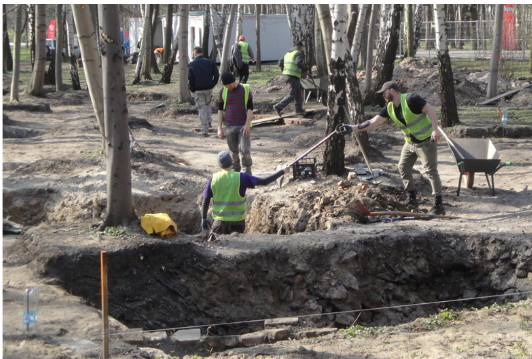
Noch sind Archäologen am Werk, bald erstehen die alten Gebäude neu: Westerplatte im April 2019.
